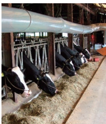
飼槽上のダクトファン
