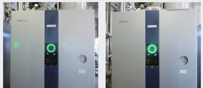
写真左から3号ボイラー、4号ボイラー
